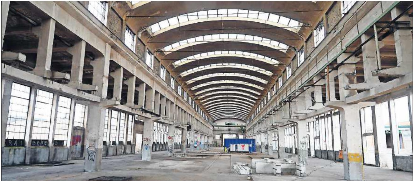
Die große Flucht in der Mitte soll erhalten bleiben: Blick in die 1910 erbaute Ibag-Halle, die unter Denkmalschutz steht.
